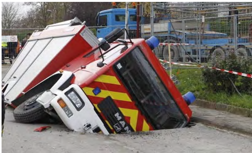
Fig.19 : Chute d'un véhicule à cause du sapement d'une route (photo du quotidien Luxemburger Wort)
